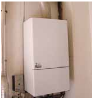
Une chaudière non entretenue peut émettre du monoxyde de carbone.
